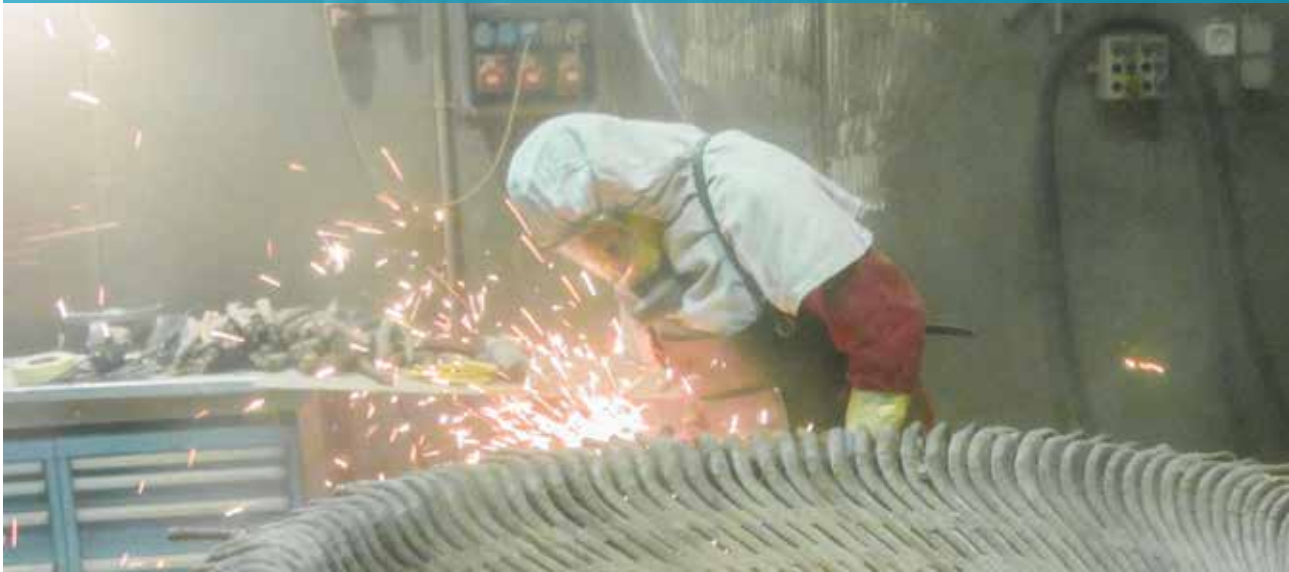
Zerlegung von Grosskomponenten in der Konditionierungsanlage
