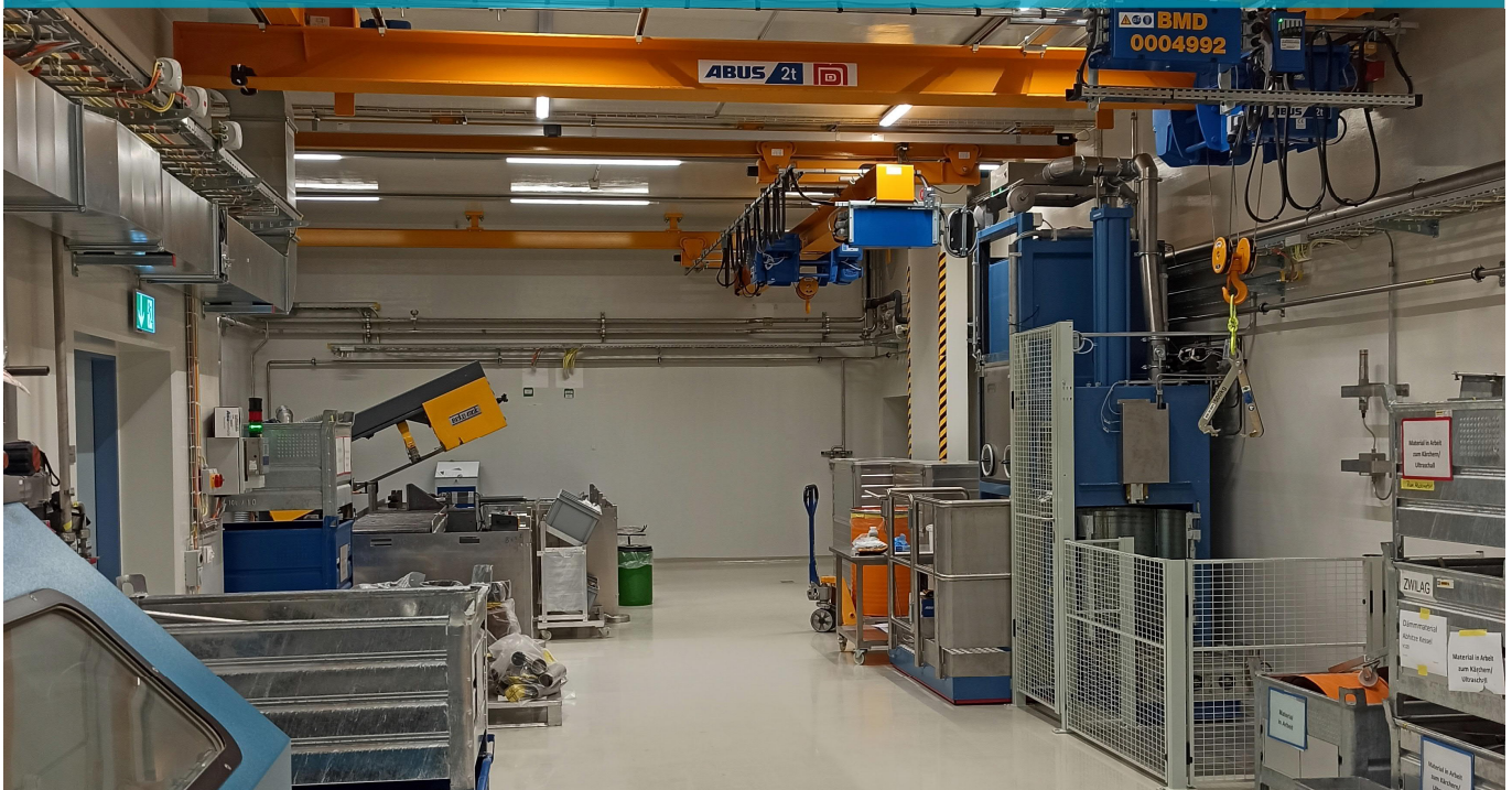
Behandlungsstrang in der Konditionierungsanlage
